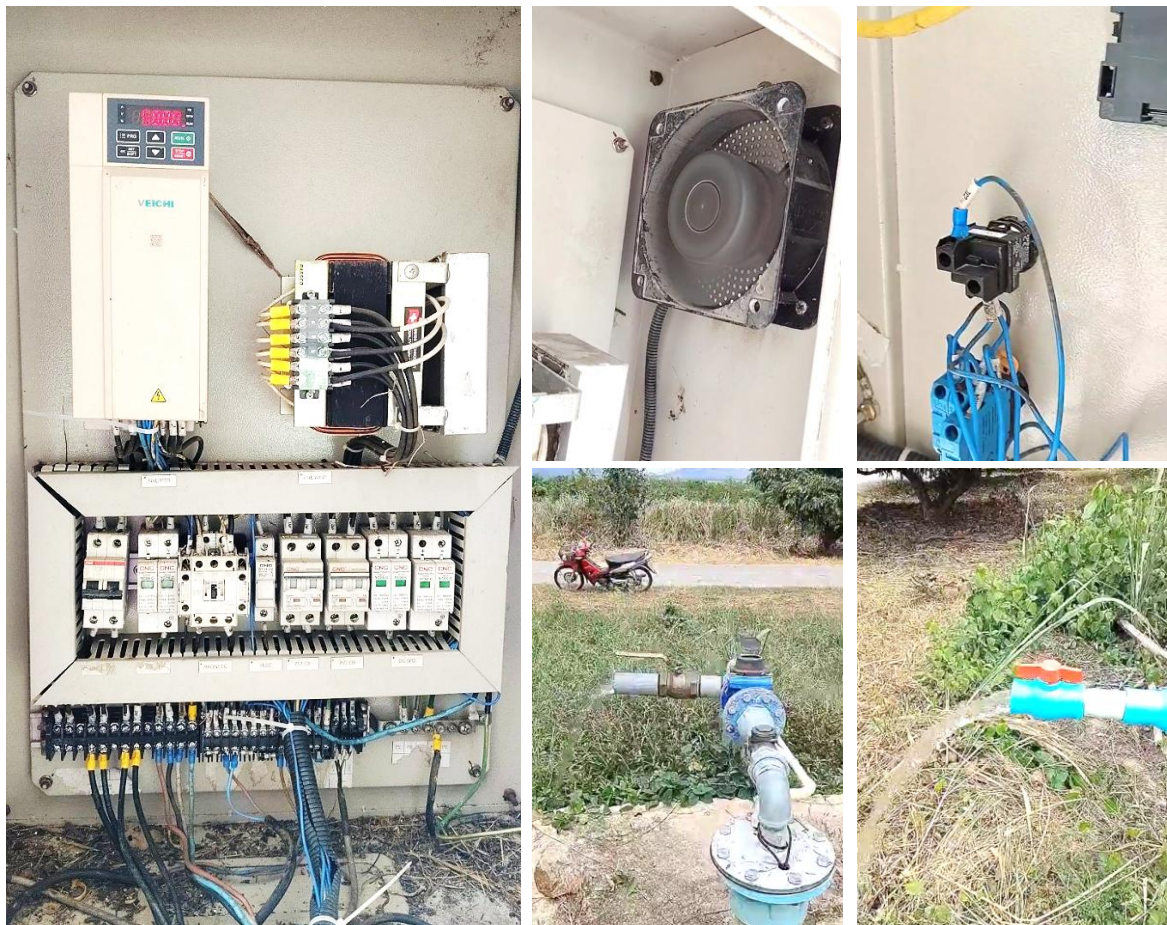
รูปที่ 41: ภาพตู้ควบคุมระบบโซลาร์เซลล์สูบน้ำของวิสาหกิจชุมชนสวนเกษตร ส.บุญมีฤทธิ์ ภายหลังการซ่อมแซมและทดสอบการจ่ายน้ำเรียบร้อยแล้ว
