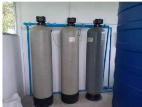
6. ระบบเครื่องกรองน้ำ
